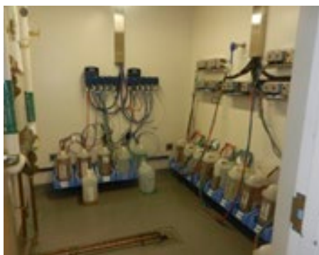
CUARTO DE INSUMOS PARA LAVADORAS MECÁNICAS
