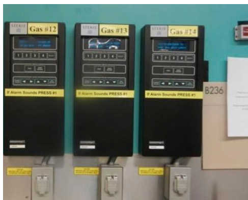
ÓXIDO DE ETILENO: UN DETALLE. LAS PANTALLAS CONTROL DE LOS EQUIPOS ESTÁN FUERA DEL CUARTO DE LOS MISMOS.
